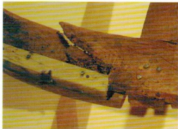
Detalle que muestra la rotura del bastidor.
